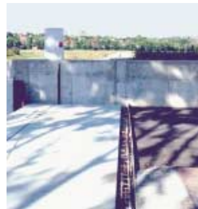
Automatisch aktivierbares System in Sinsheim Automatic activated system in Sinsheim
